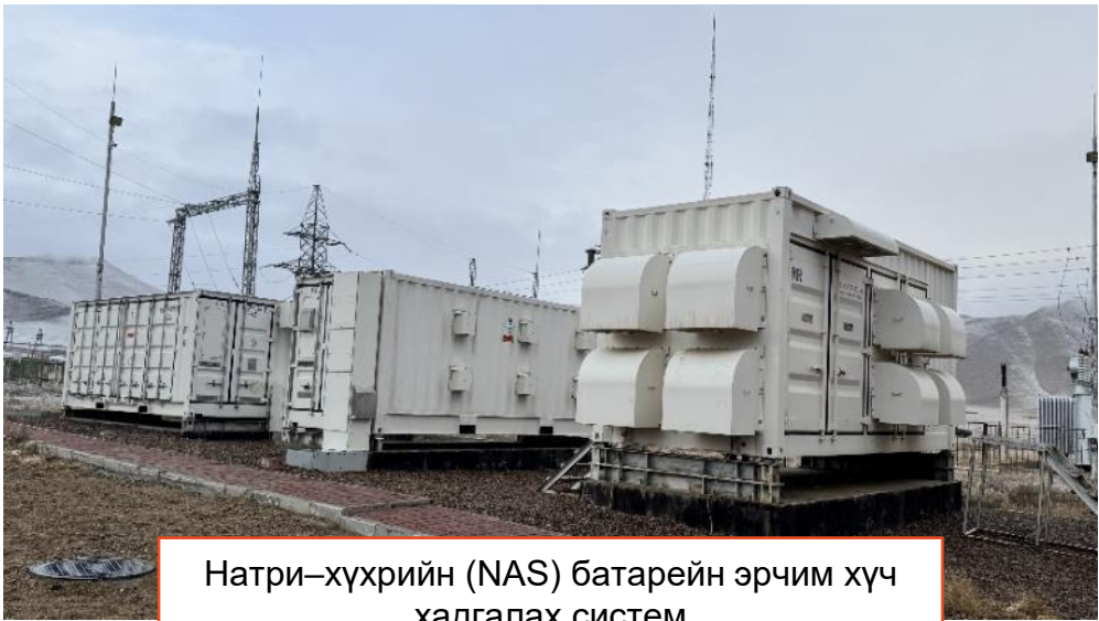
Улиастайд байрлах 5 МВт-ын нарны цахилгаан станц
