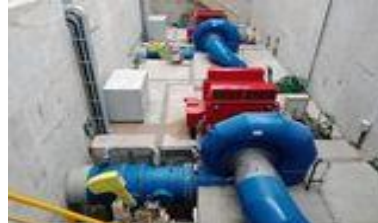
УЦС, Toyo Energy Farm Co., Ltd., Индонез
